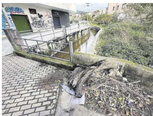
Residuos extraídos del cauce y que siguen sin retirar. | G.Núñez
