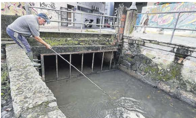
Un vecino, retirando lodos y heces del cauce del río Bouzós, que baja turbio y con hedor. | G.Núñez
